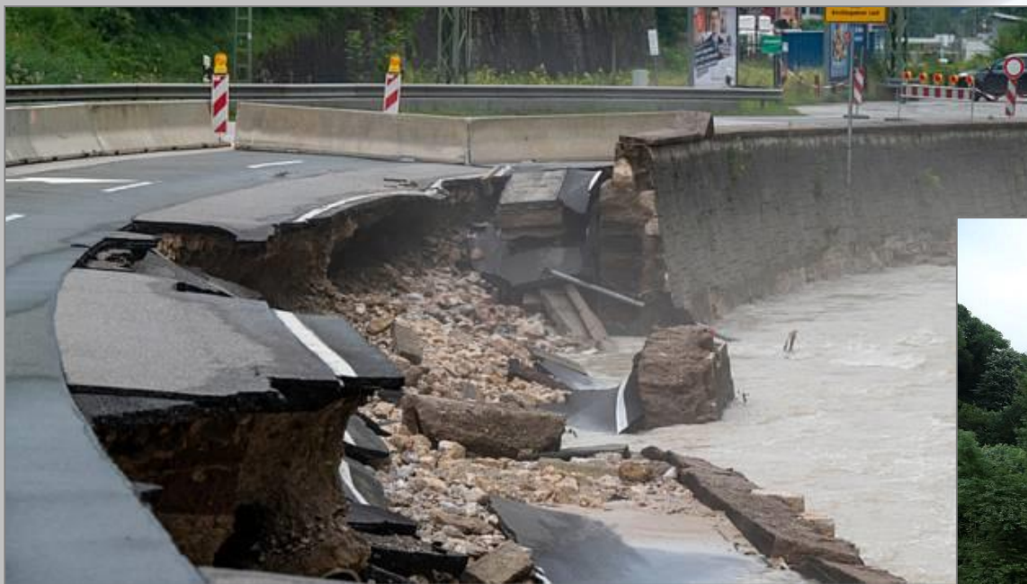
Záplavami poničená silnice u města Berchtesgaden v Německu (19. 7. 2021), foto: ČTK
